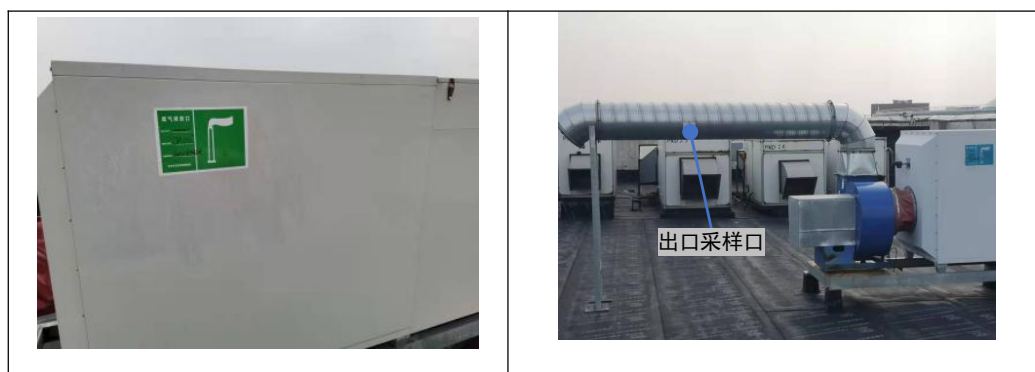
图 3-3 101 车间 DA025 废气环保设施
