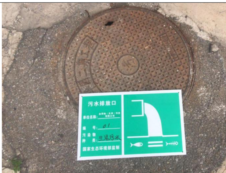
污水总排口及标识牌
