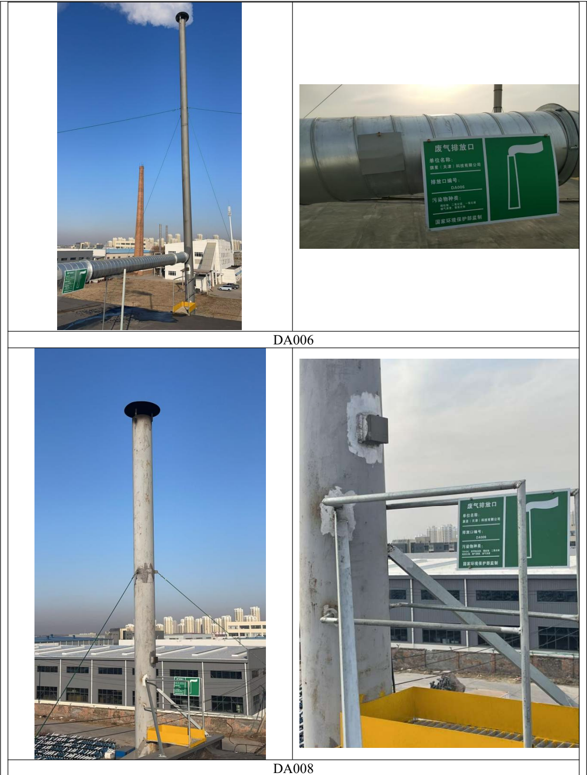
图 3-7 废气排放口规范化建设情况
