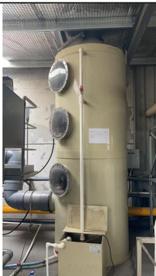
TA005 碱喷淋塔
