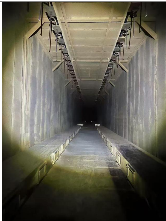
电泳线烘干炉
