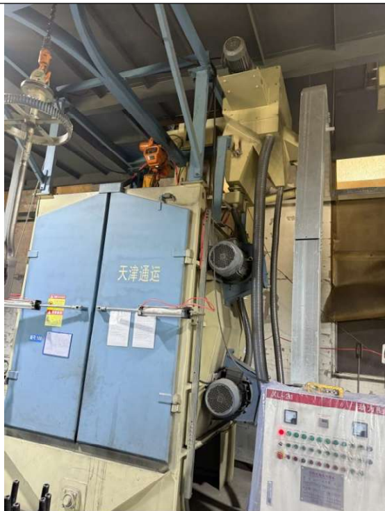
抛丸机自带除尘设施
