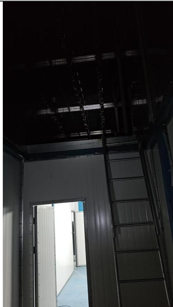
喷粉线固化炉
